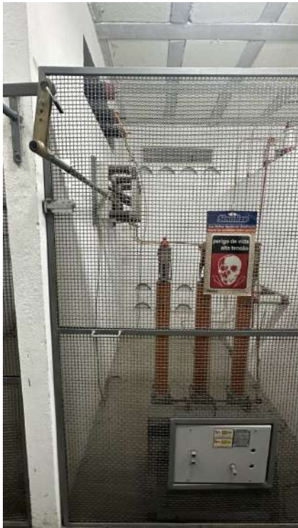
10. CUBÍCULO DE DISJUNÇÃO
