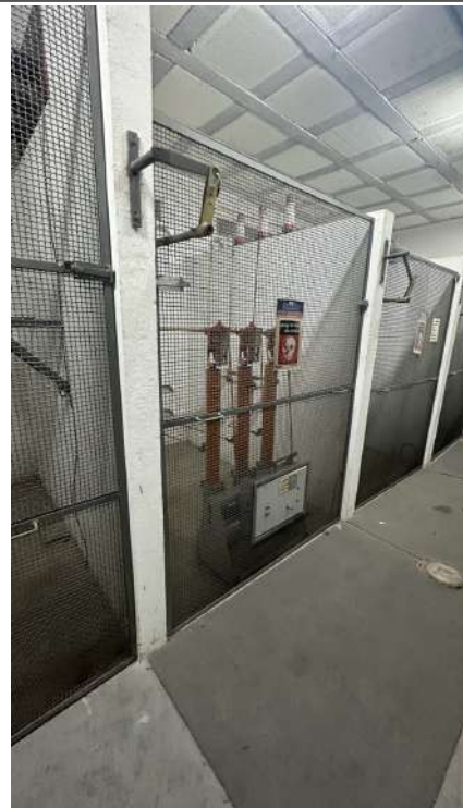
Foto 24(Vista interna da subestação)
