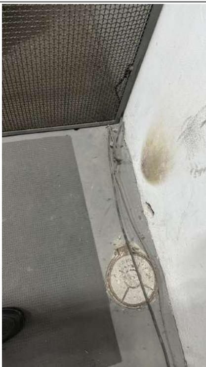
Foto 27(Vista interna da subestação)
