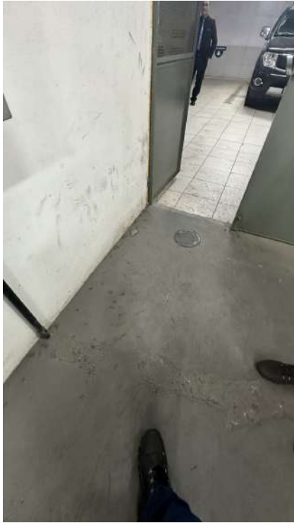
Foto 21(Vista interna da subestação)
