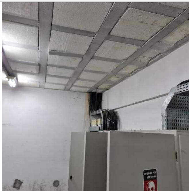
Foto 12(Vista interna da subestação)
