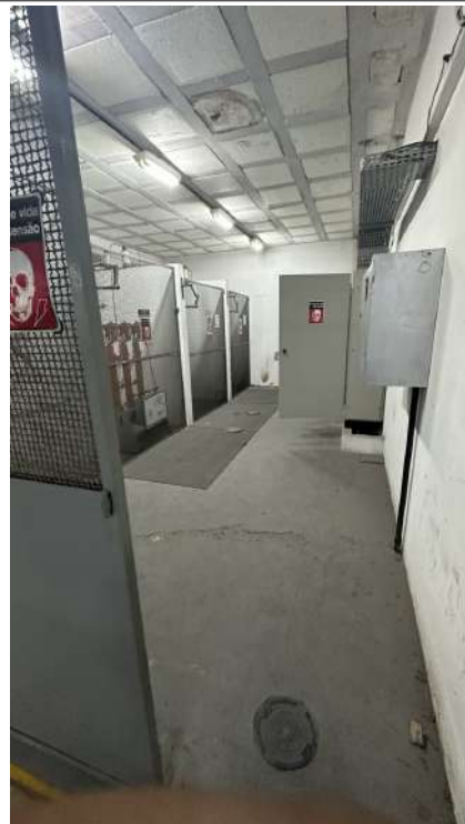
6. VISTA INTERNA DA SUBESTAÇÃO
