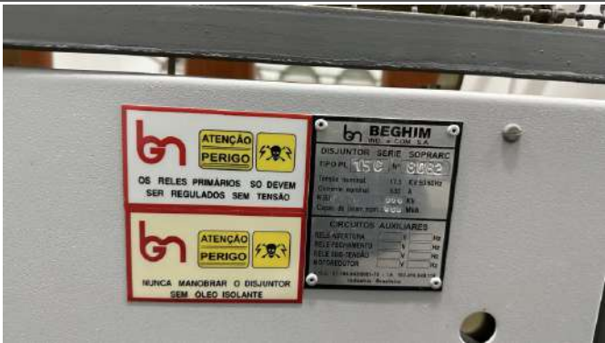
11. DISJUNOTR DE MÉDIA TENSÃO
