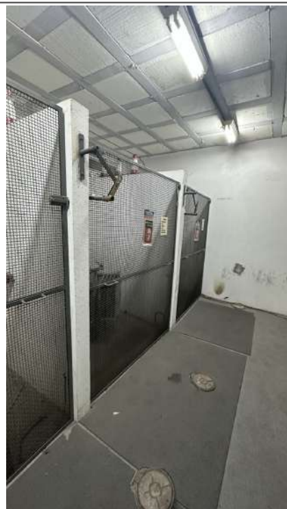
16. CÚBICULO DE TRANSFORMAÇÃO - 2 TRANSFORMADORES DE 300 KVA
