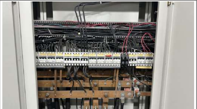
24. QGBT - CIRCUITOS INTERNOS
