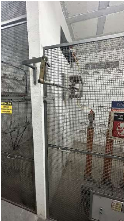
Foto 25(Vista interna da subestação)
