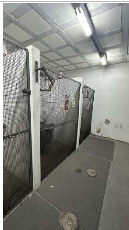
16. CÚBICULO DE TRANSFORMAÇÃO - 2 TRANSFORMADORES DE 300 KVA
