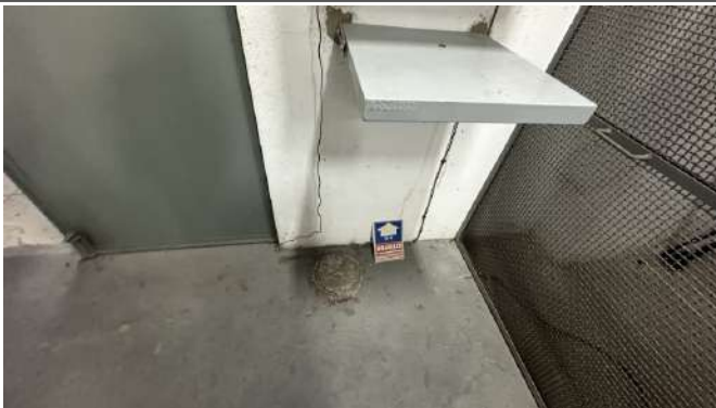
Foto 23(Vista interna da subestação)
