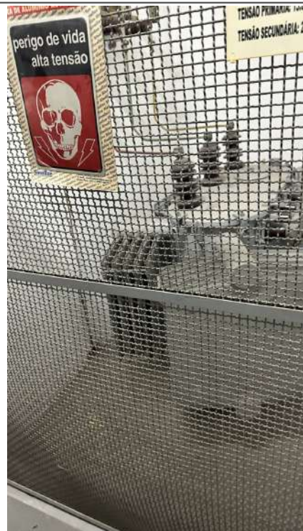
Foto 28(Vista interna da subestação)
