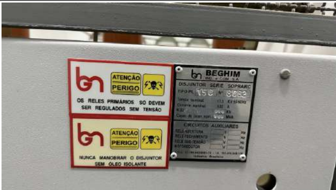
11. DISJUNOTR DE MÉDIA TENSÃO
