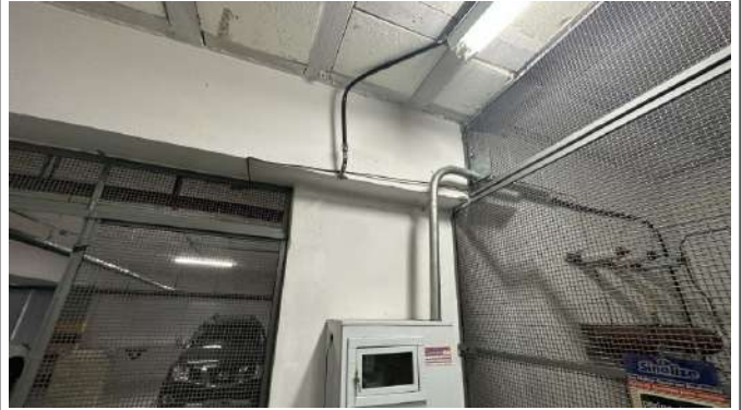
Foto 22(Vista interna da subestação)
