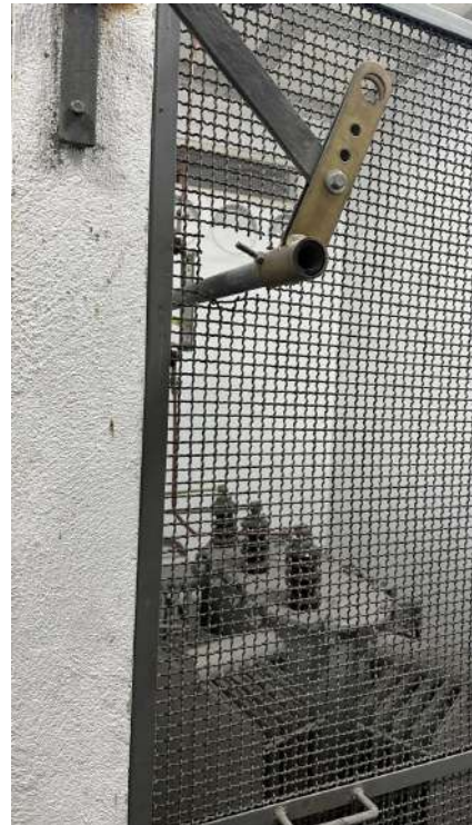
Foto 26(Vista interna da subestação)
