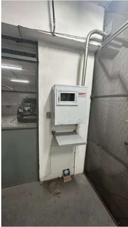
9. LOCAL DO QUADRO DE MEDIÇÃO DA MÉDIA TENSÃO
