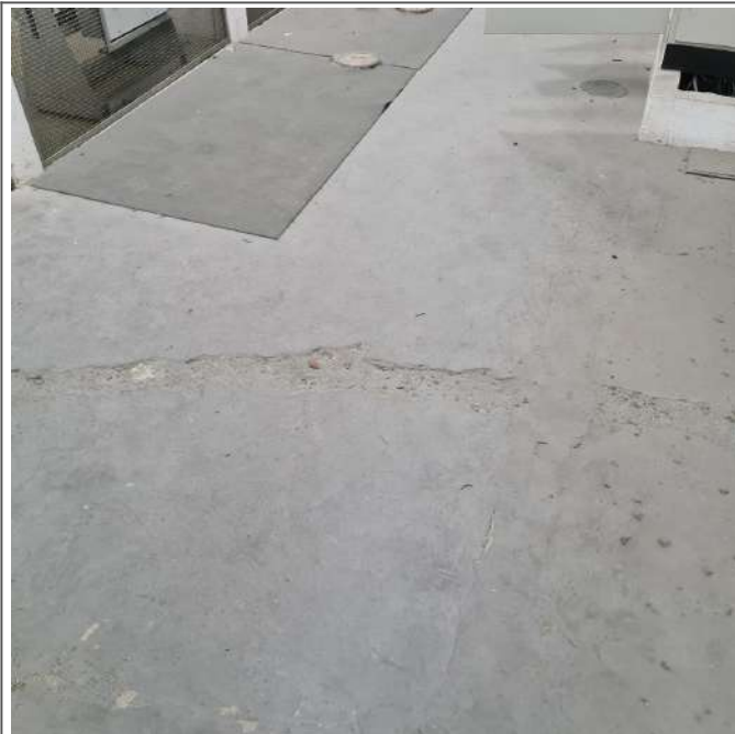
Foto 17(Vista interna da subestação - fissura no piso cimentado)
