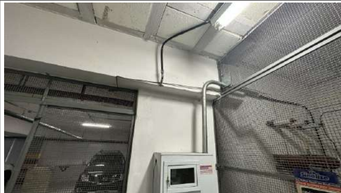
Foto 22(Vista interna da subestação)
