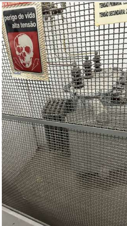
17. CUBÍCULO DE TRANSFORMAÇÃO
