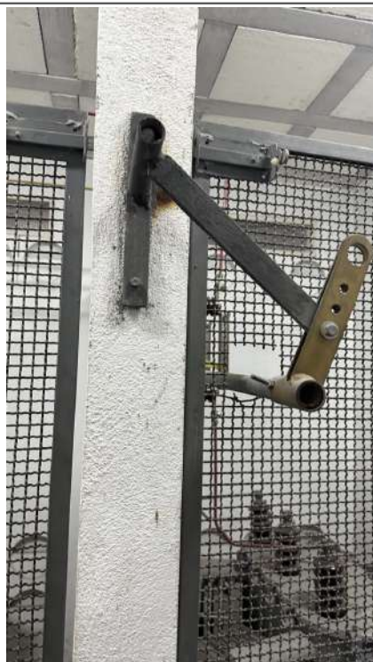
20. BLOQUEIO DA CHAVE SECCIONADORA
