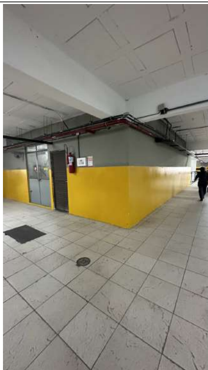
3. CÚBILO DA SUBESTAÇÃO ABRIGADA
