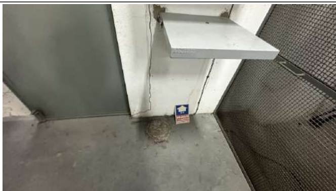
Foto 23(Vista interna da subestação)
