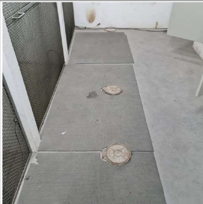
Foto 18(Vista interna da subestação)
