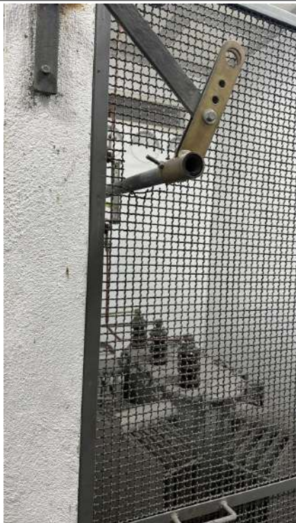
Foto 26(Vista interna da subestação)
