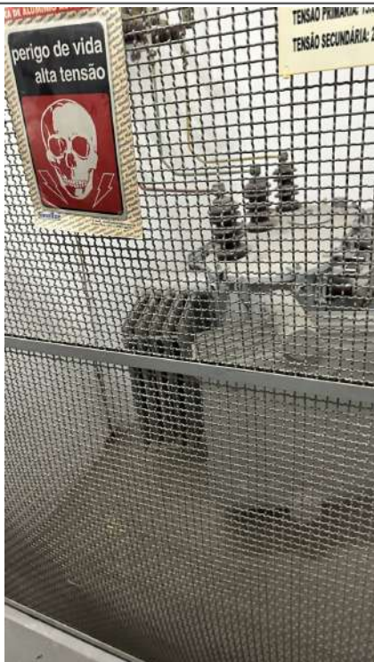
Foto 28(Vista interna da subestação)
