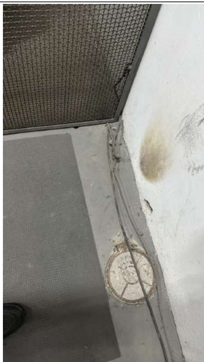
Foto 27(Vista interna da subestação)
