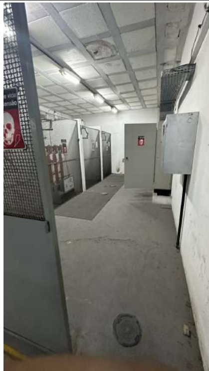
6. VISTA INTERNA DA SUBESTAÇÃO
