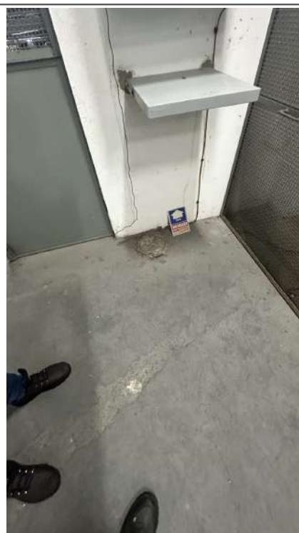
Foto 20(Vista interna da subestação)
