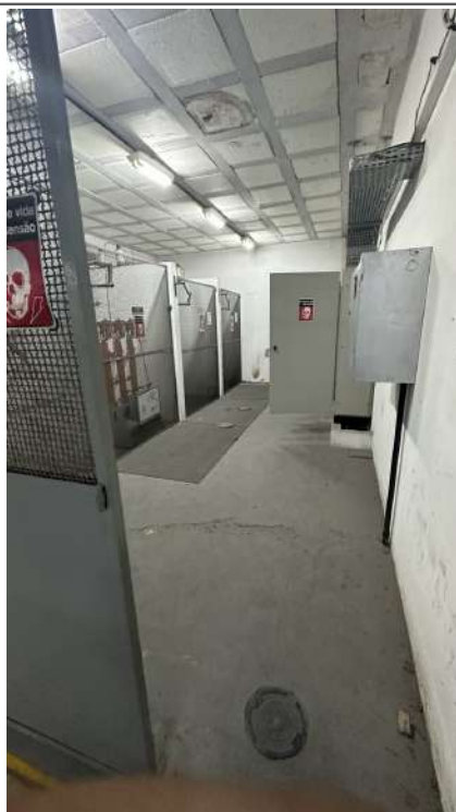
Foto 11(Vista interna da subestação)
