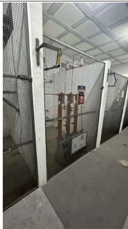
Foto 24(Vista interna da subestação)
