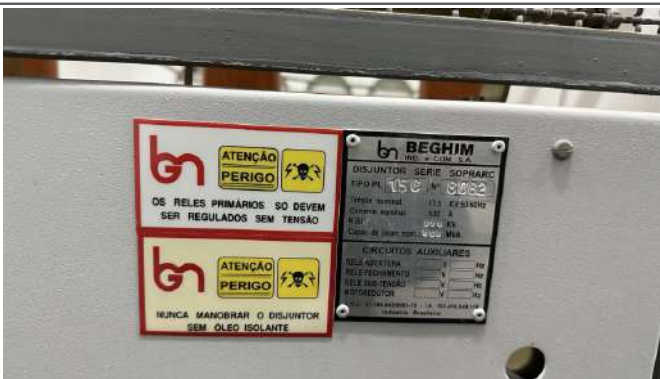
11. DISJUNTOR DE MÉDIA TENSÃO
