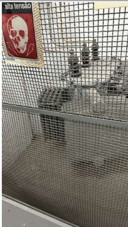
Foto 29(Vista interna da subestação)
