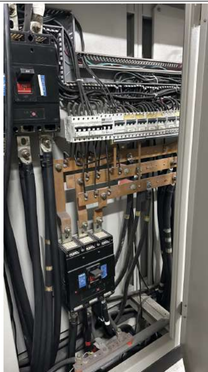
22. QUADRO GERAL DE BAIXA TENSÃO
