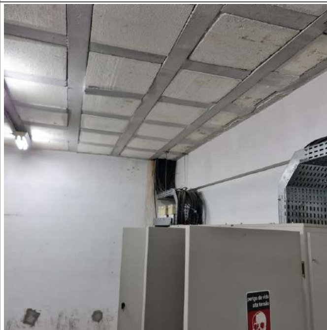
Foto 12(Vista interna da subestação)
