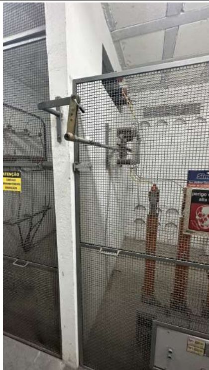
Foto 25(Vista interna da subestação)
