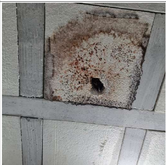
Foto 16(Vista interna da subestação - ponto de infiltração no teto)
