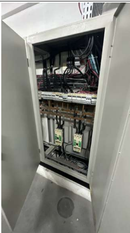
23. BARRAMENTOS DO QUADRO GERAL DE BAIXA TENSÃO
