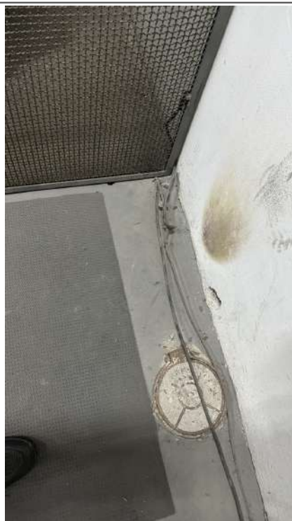
28. MALHA DE ATERRAMENTO
