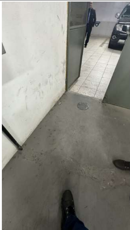
Foto 21(Vista interna da subestação)
