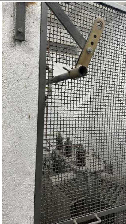
18. CHAVE DE ABERTURA DO TRANSFORMADOR
