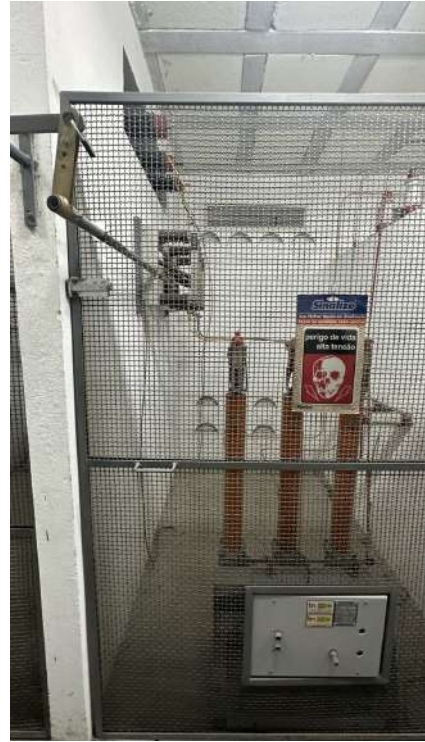
10. CUBÍCULO DE DISJUNÇÃO
