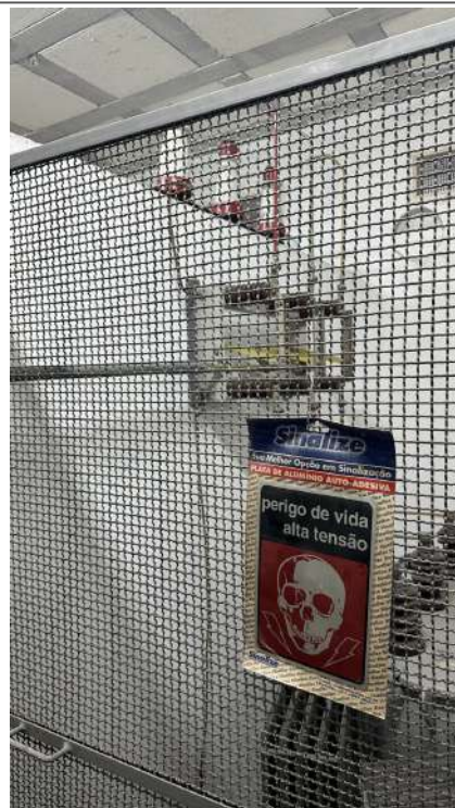
Foto 30(Vista interna da subestação)
