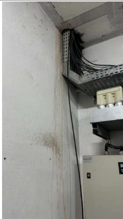
26. SAÍDA DAS INSTALAÇÕES DE BAIXA TENSÃO
