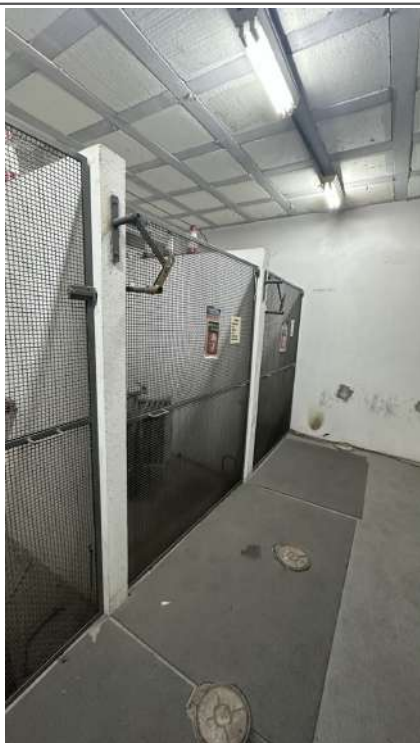
16. CÚBICULO DE TRANSFORMAÇÃO - 2 TRANSFORMADORES DE 300 KVA
